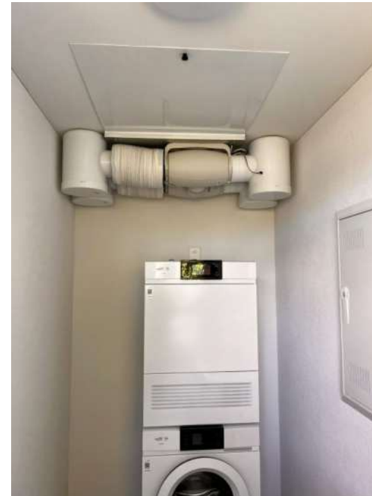
Verteiler mit Lüftungsgerät Finish
