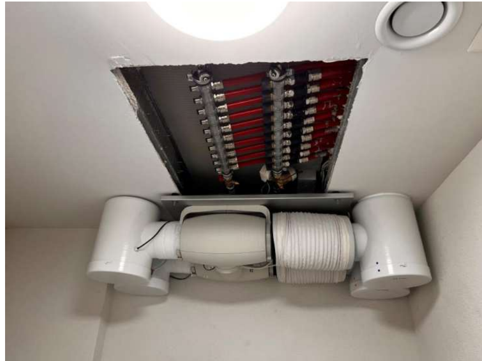
Einlage Verteiler mit Lüftungsgerät
